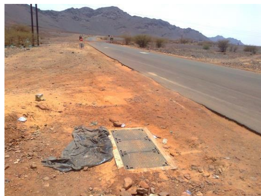
Exemple de chambre enterrée avec tampon en fonte
