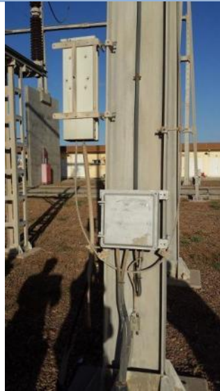
Figure 27 Terminaison SOGEM de Nouakchott
