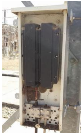
Figure 20 Intérieur de la boîte de jonction de Manantali vers Kayes
