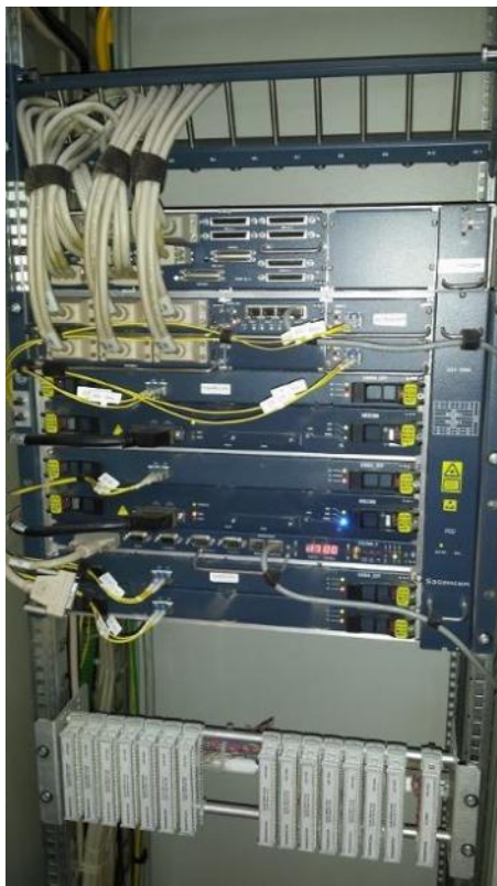
Figure 25 Équipement STM-64 Sagem de Kita
