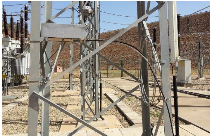
Figure 18 Boîte de jonction de Manantali vers Kita (côté)
