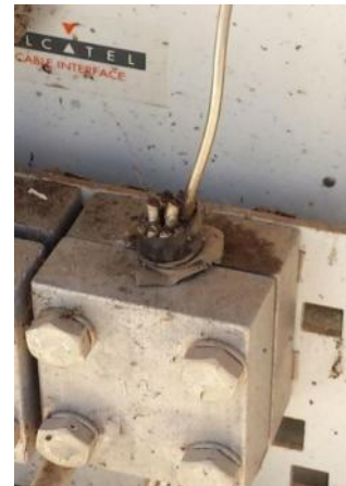
Figure 21 Terminaison CGFO de la boîte de jonction de Manantali vers Kayes
