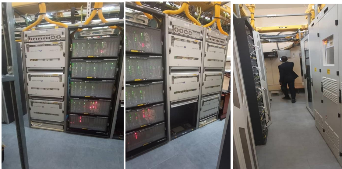
CLS (station d'atterrissage par câble) de ACE - Nouakchott
